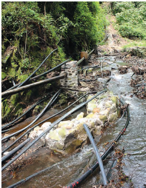
Foto 108. Captación de agua en río Amatzinac. Tetela del Volcán, Tetela del Volcán. 2011.
